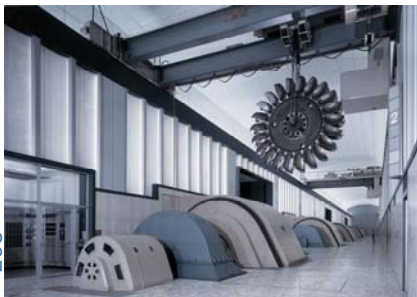
La salle des turbines à Chandoline
